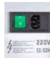
Рис 2 – Панель главного выключателя
