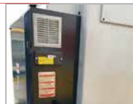
Система вентиляции электрического шкафа (вентилятор)
