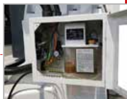
Станция системы автоматической смазки и подключения пневматики
